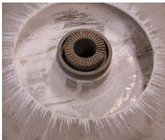
Verschmutzte und korrodierte Sprüheinrichtung
